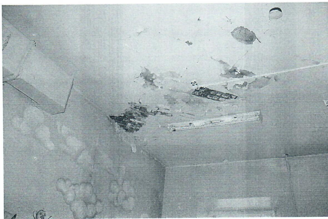
Фото 31. Состояние перекрытий второго этажа.
