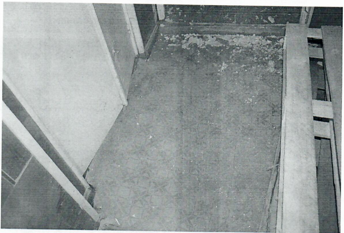
Фото 19. Состояние напольного покрытия.
