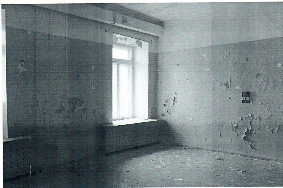
Фото 27. Шелушение красочного слоя на стенах.
