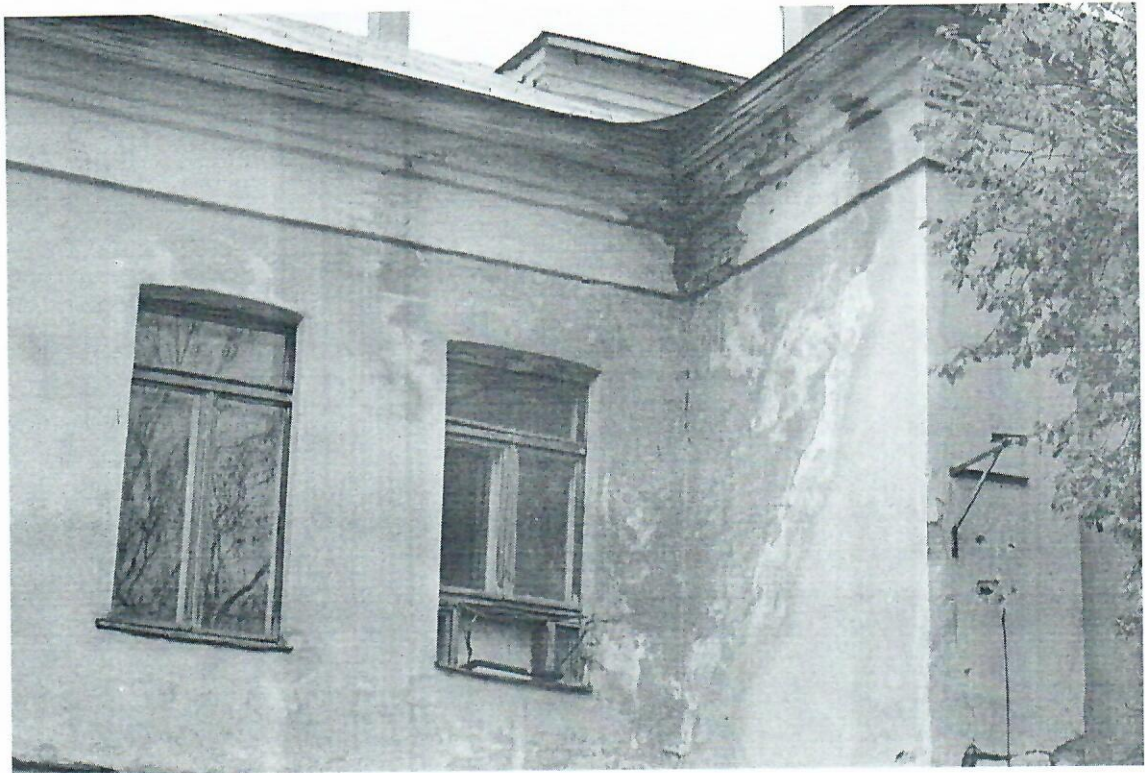
Фото 6. Состояние стен и карнизной части.
