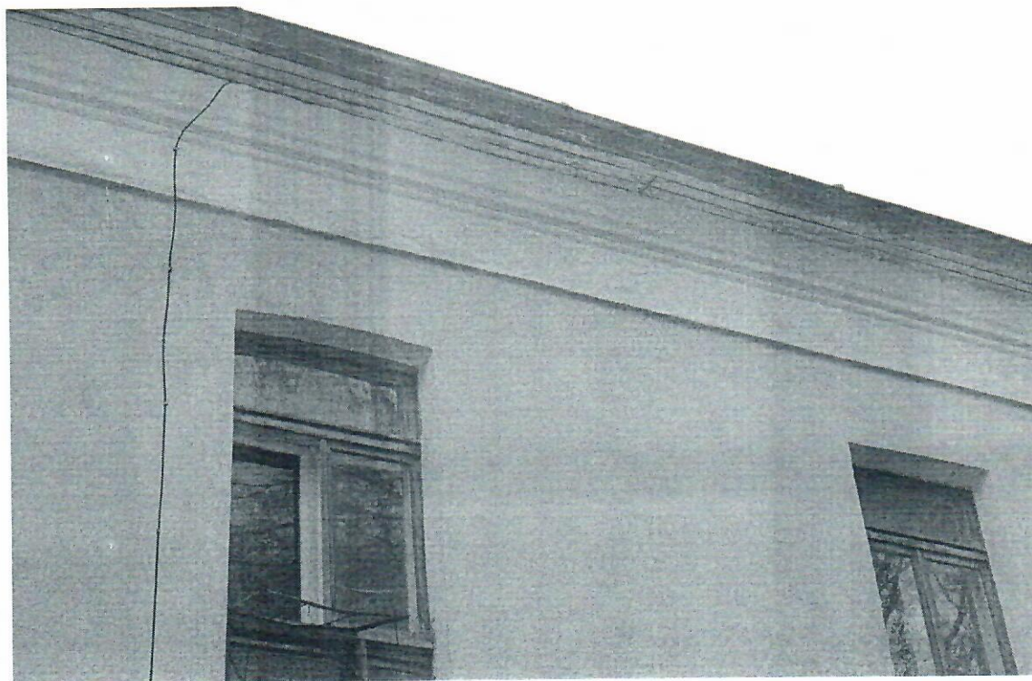
Фото 11. Состояние карнизной части.
