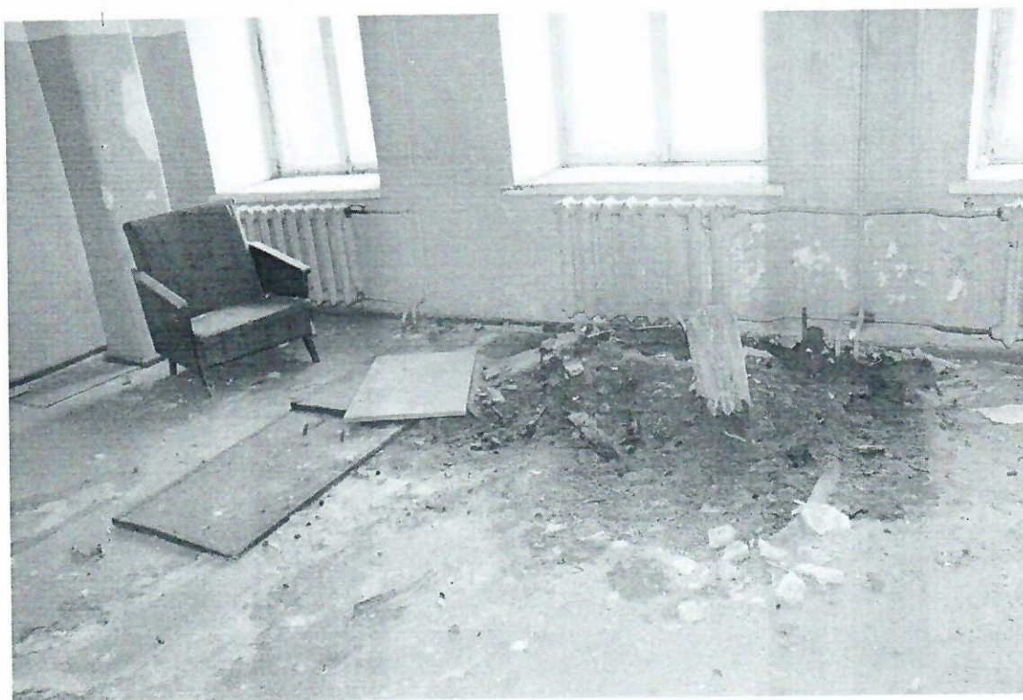
Фото 30. Состояние полов и стен.
