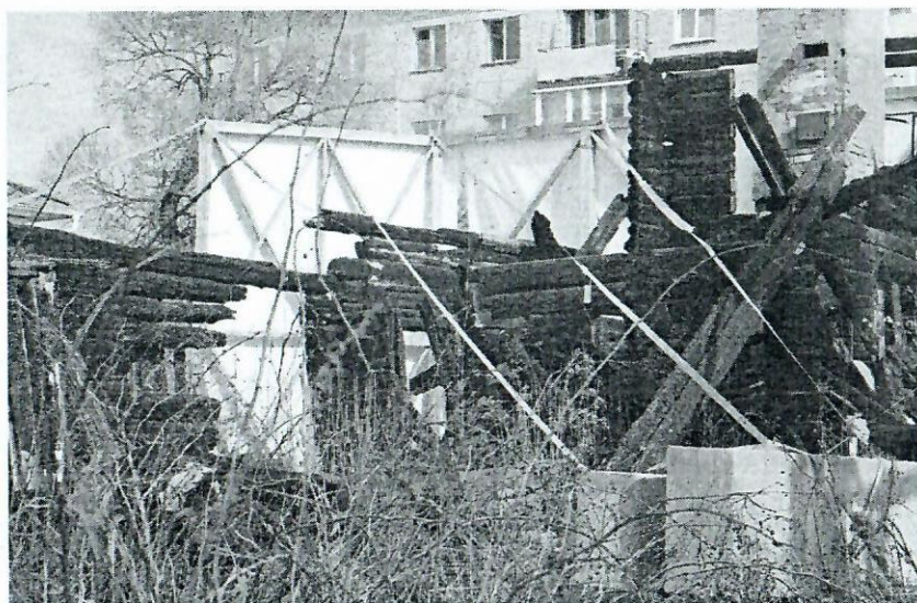
Фото 5. Руины объекта и каркас с креплением баннера.
