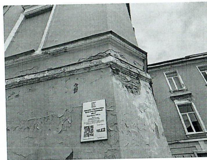
Фото 17. Состояние декоративных элементов.
