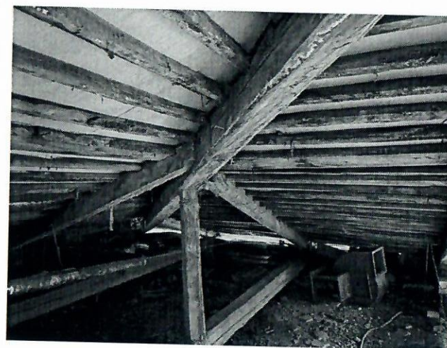
Фото 89. Состояние элементов стропильной системы.
