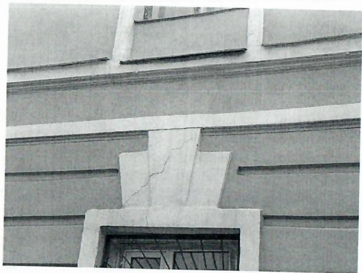
Фото 18. Состояние декоративных элементов.
