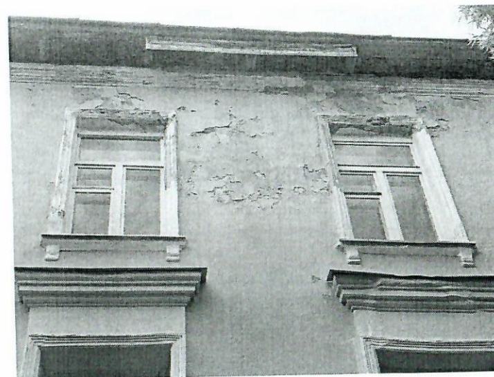
Фото 16. Состояние стен, окон и карниза.
