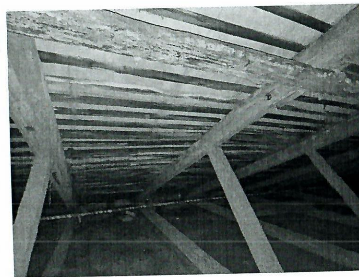
Фото 85. Состояние элементов стропильной системы.
