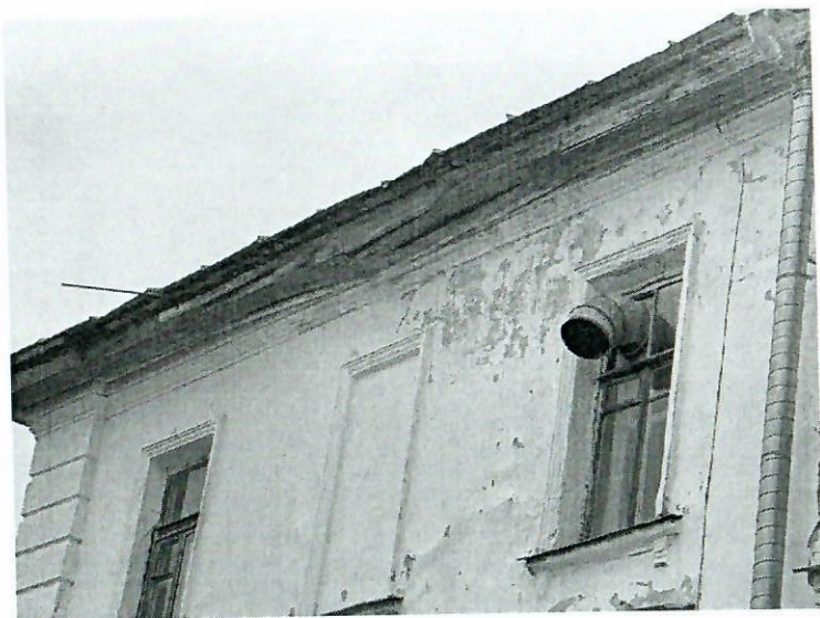
Фото 22. Состояние карнизной части.
