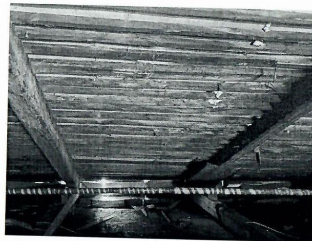
Фото 88. Состояние элементов стропильной системы.
