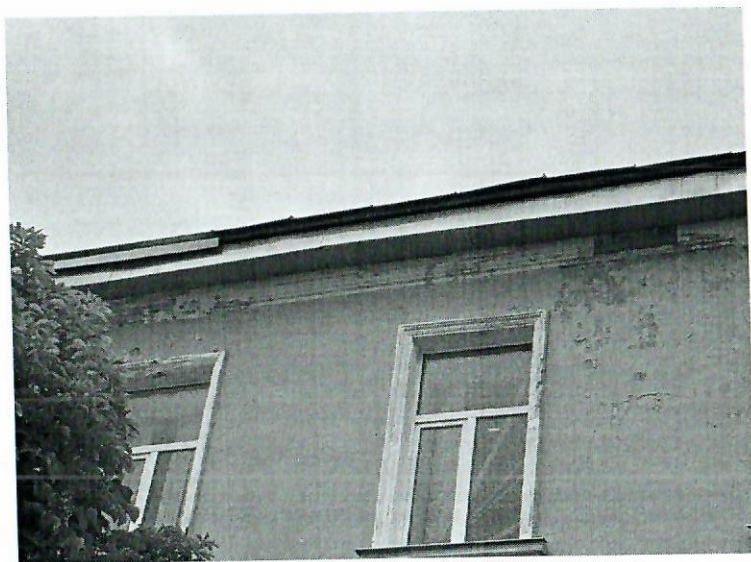
Фото 23. Состояние карнизной части.
