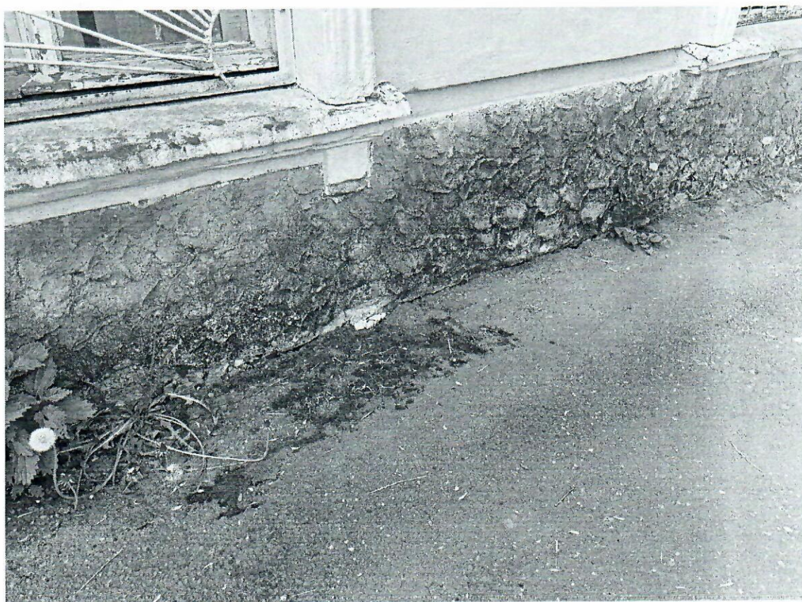
Фото 9. Состояние цокольной части.
