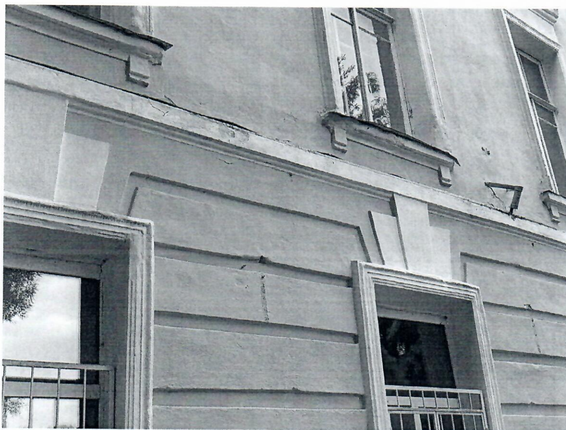
Фото 11. Состояние декоративных элементов.
