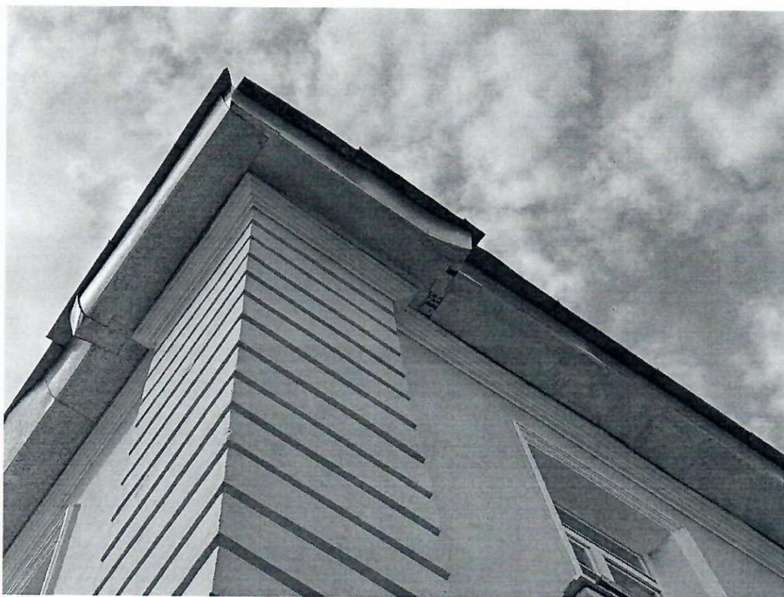
Фото 15. Состояние карнизной части.
