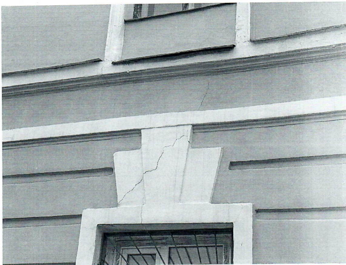
Фото 12. Состояние декоративных элементов.
