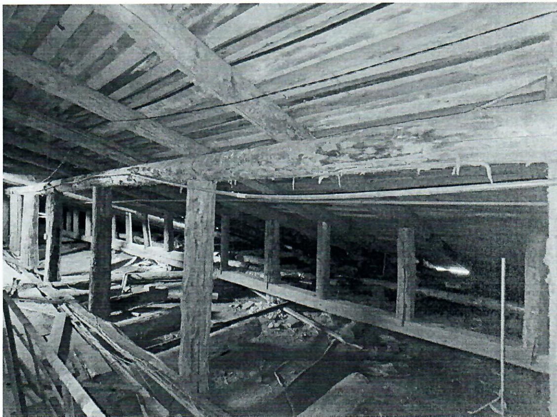
Фото 57. Состояние элементов стропильной системы.
