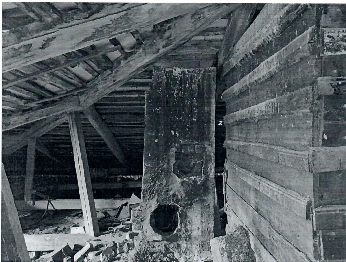
Фото 55. Состояние элементов стропильной системы и печи.
