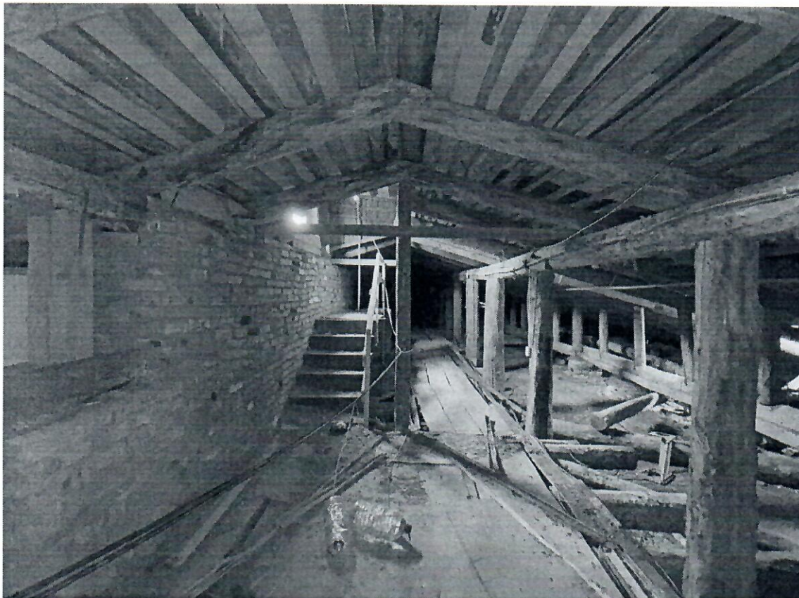
Фото 58. Состояние элементов стропильной системы.
